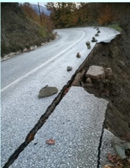
Κατεστραμμένο τμήμα του δρόμου Σαραντάπορο -Νεραΐδα μετά τη θεομηνία «ΙΑΝΟΣ»
