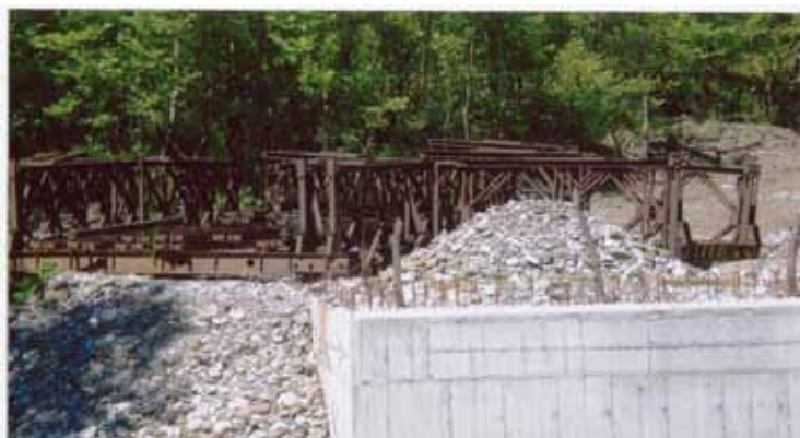
Τα τσιμεντένια βάθρα περιμένουν ακόμα να στηθεί πάνω τους η γέφυρα.
