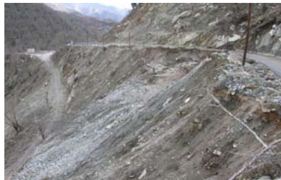
Θέση «Λογγές». Εδώ πρέπει τάχιστα να γίνει το τοιχίο για να αποκατασταθεί επιτέλους και η δεύτερη λωρίδα της επαρχιακής οδού. Κακοτεχνίες έργων που κάποιοι πρέπει να ντρέπονται!
